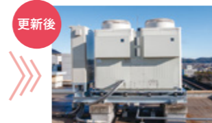
更新後 ホットウォーターヒートポンプ (耐塩害仕様) CAHV-P500AK2-H-BS×1台
