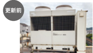
更新前 空冷式ヒートポンプチラー (加熱専用機) CAH-500BQ-H×1台
