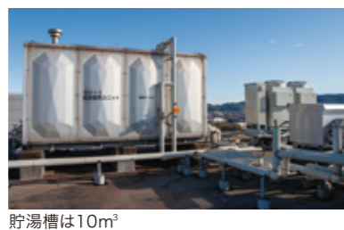
貯湯槽は10m³
