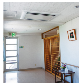
▲ ユニットの入口も広々としている。通路の空調用には2方向と4方向の天井カセット形を場所に合わせて選定
