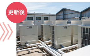
更新後 更新後の室外ユニットも屋上に集中設置
