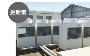
更新前 既設は三菱電機のシティマルチYe(2004年から使用)
