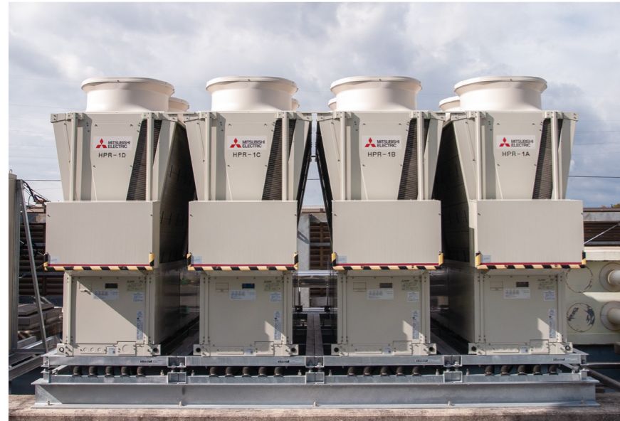
▲ 空冷式ヒートポンプチラー(DT-RⅢ)は60馬力相当のポンプ内蔵タイプ(CAHV-MP1800B-P)4台を採用。エネセン棟の屋上、冷却塔の撤去跡に設置した
