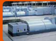
タービン発電機
