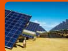
太陽光発電システム
