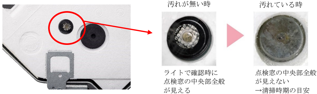
(図7) ドレンパン点検窓 確認例
