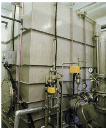
オゾン反応槽ユニット
