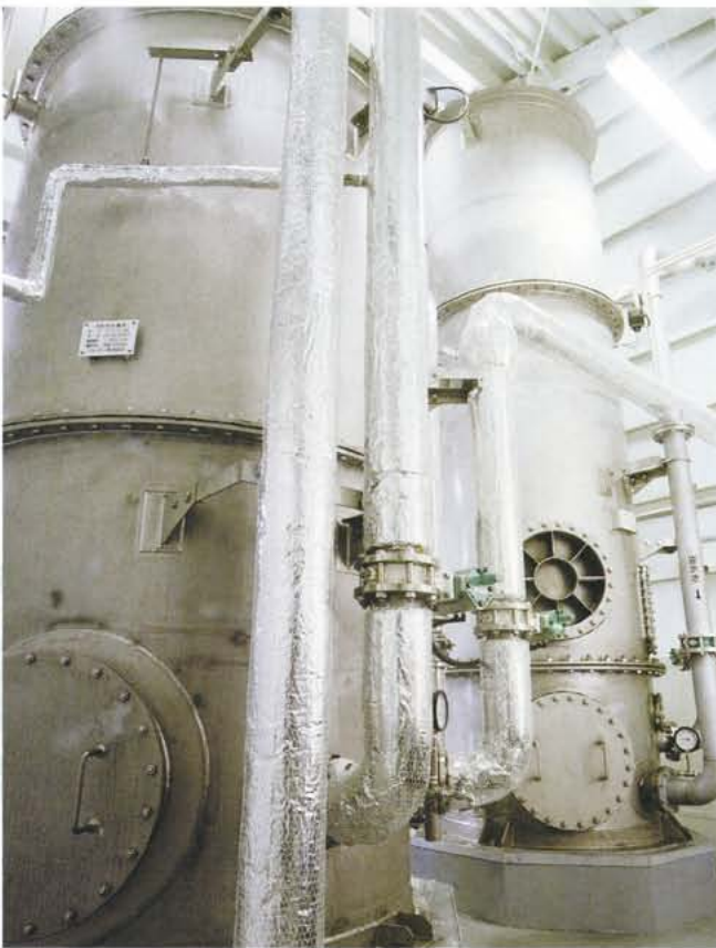
活性炭吸着塔
