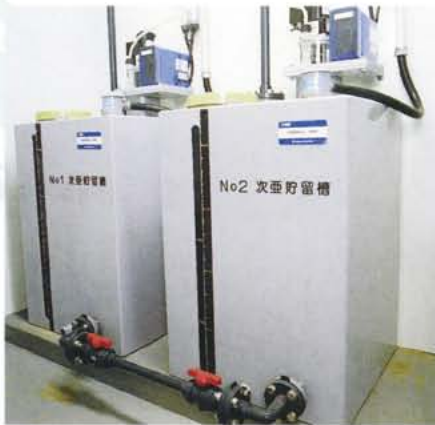
次亜注入装置
