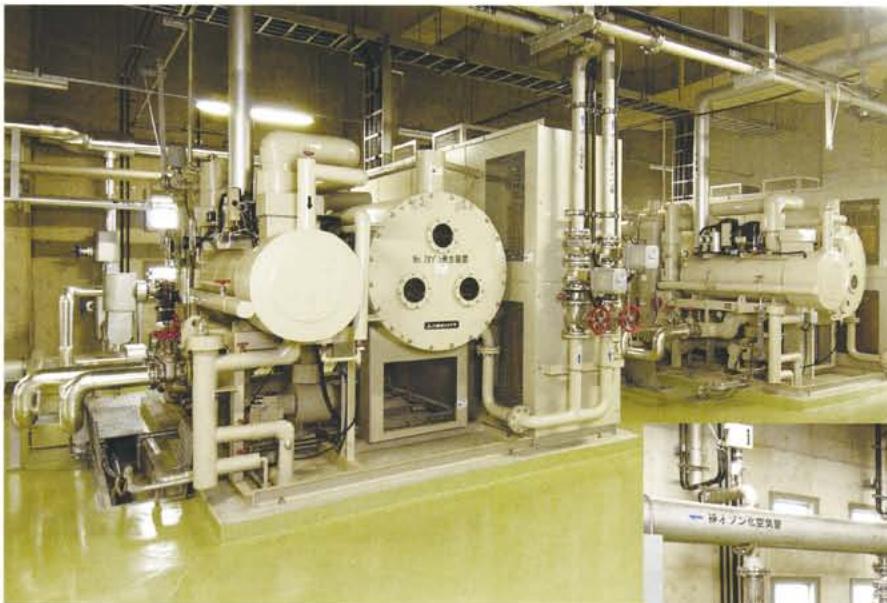
▲ オゾン発生装置
