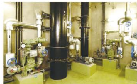
▲ 冷却水ストレーナー・ポンプ
