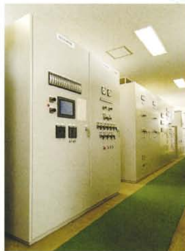
▲ 高度処理設備制御盤
