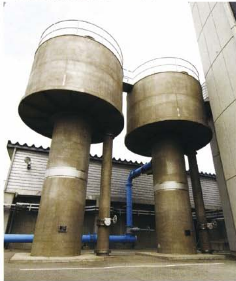
▼ オゾン接触槽（Uチューブ）
