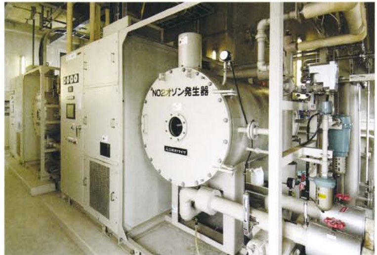
▲ オゾン発生装置
