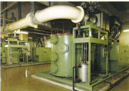
▲ 排オゾン分解塔
