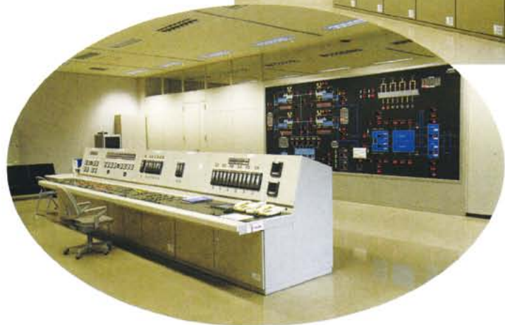
▲ 中央監視操作室
