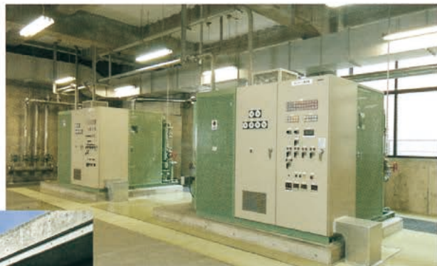
▲ オゾン発生装置
