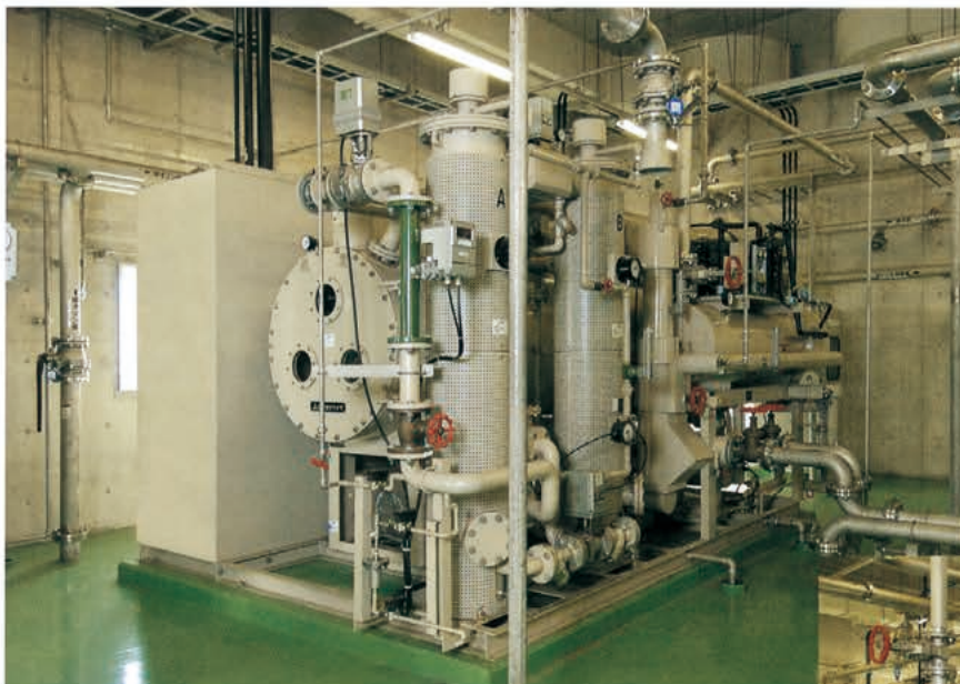
▲ オゾン発生装置
