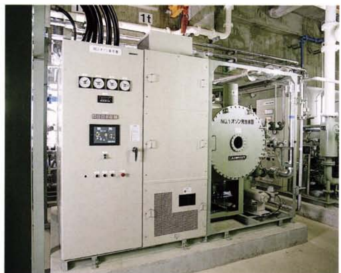
オゾン発生装置
