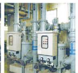
酸素発生装置関連設備
