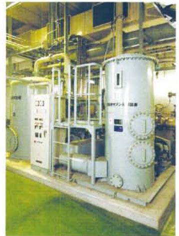
▲ 排オゾン分解装置
