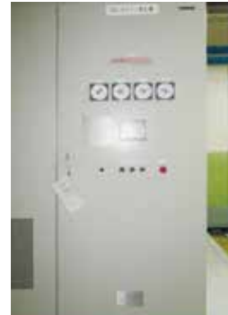
▲ オゾン操作盤
