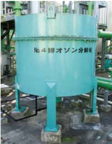
▲ 排オゾン分解塔
