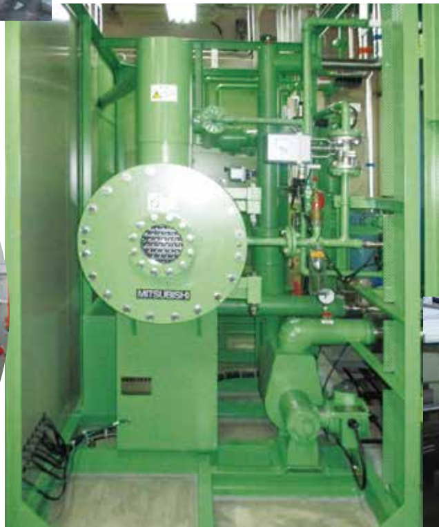
▲ オゾン発生装置
