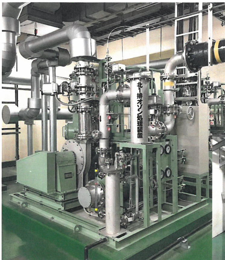
▲ 排オゾン処理装置
