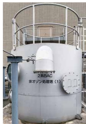
▲ 排オゾン処理塔(BAC用)
