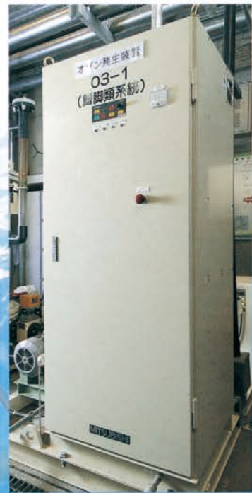
▲ オゾン発生装置
