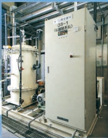
▼ オゾン浄化装置
