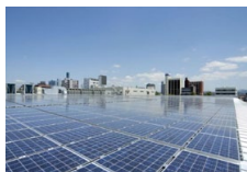
太陽光パネル
