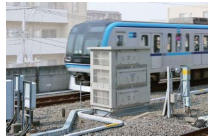
駅舎補助電源装置の駅ホーム端設置状況
